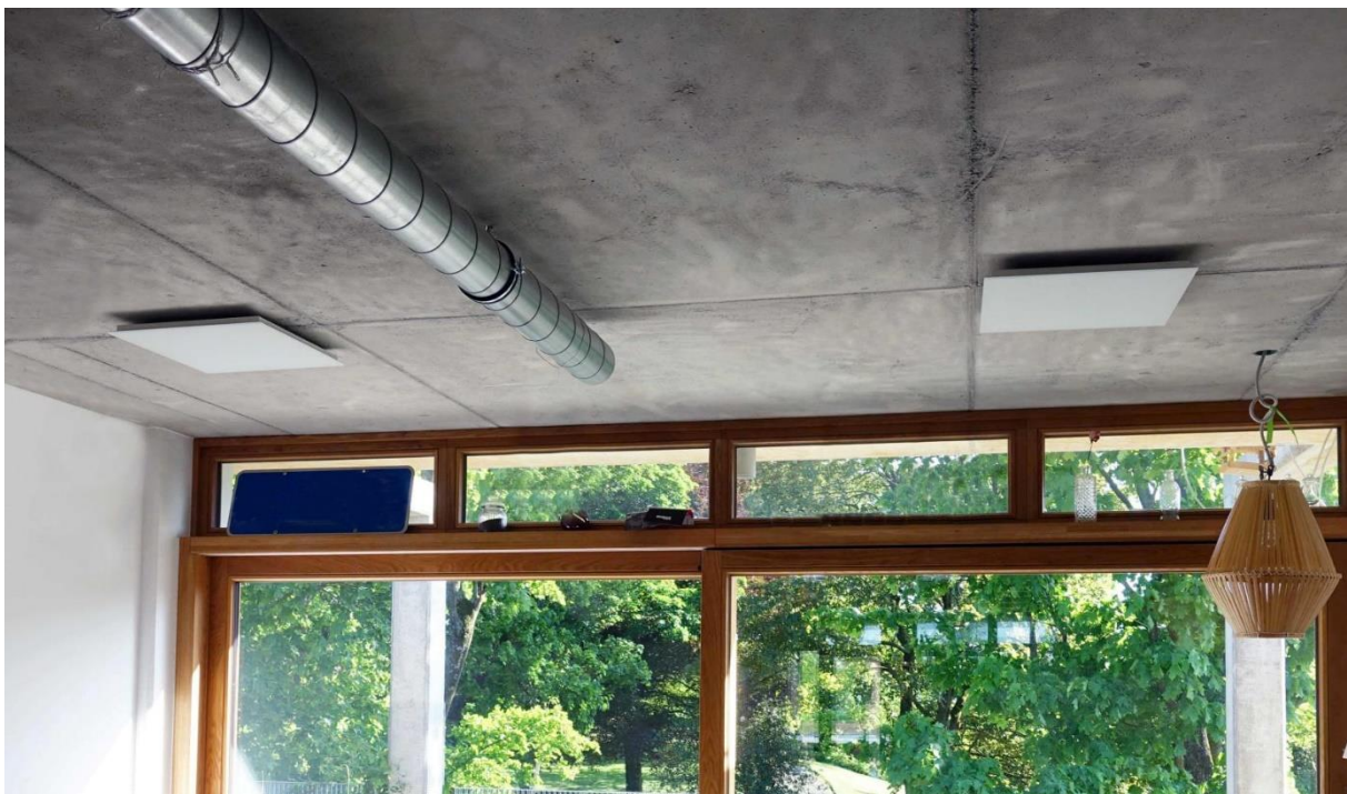
Abb. 13 Infrartheizungen K76 links und rechts sowie Lüftungsleitung
