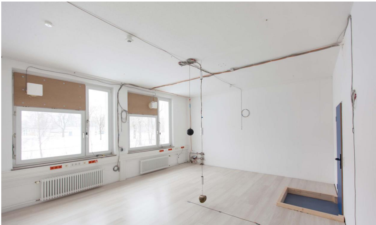
Abb. 40 Laborraum T1 mit wassergeführter Fußbodenheizung
