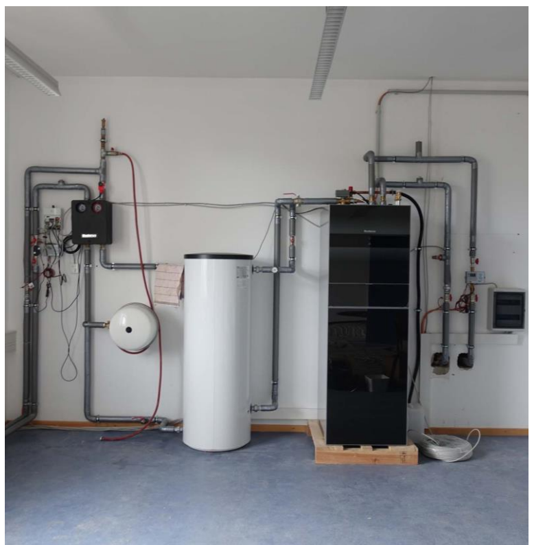
Abb. 42 Technikraum für Wärmepumpe mit Pufferspeicher
